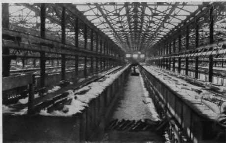
52. ábra. Vízelektrolízis Észak-Koreában, melyhez az áramot a közeli hidroelektromos erőművekből kapják. (A kép a berendezést a háború által megrongált állapotban, télidőben mutatja be)
