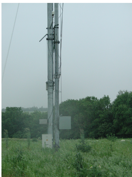
c) A torony alján található berendezések elhelyezése (tápfeszültség, adattároló stb.)
