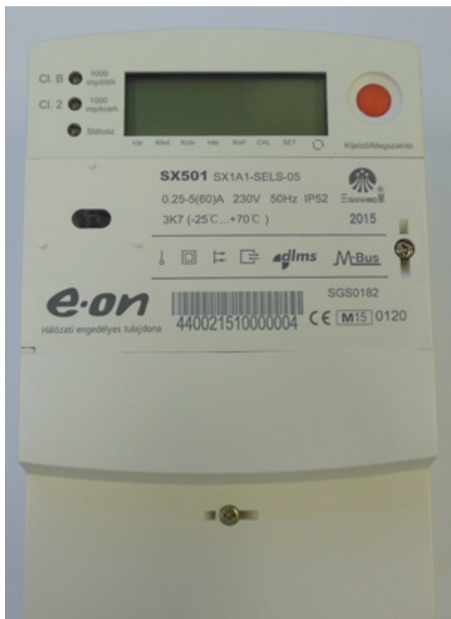
1 fázisú, típusa, SX501 5-60 A Kommunikáció: GPRS.
